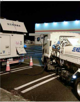
2016年に発生した熊本地震の際には、発電機へ燃料を供給し、被災された建物を連絡先で必要なエネルギーを供給しました。
